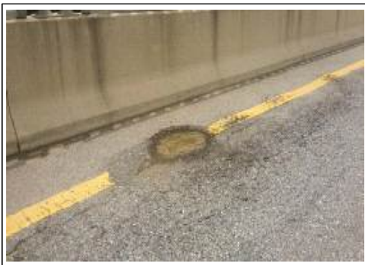
S32 (원주방향) 아스콘 파손 및 망상균열
