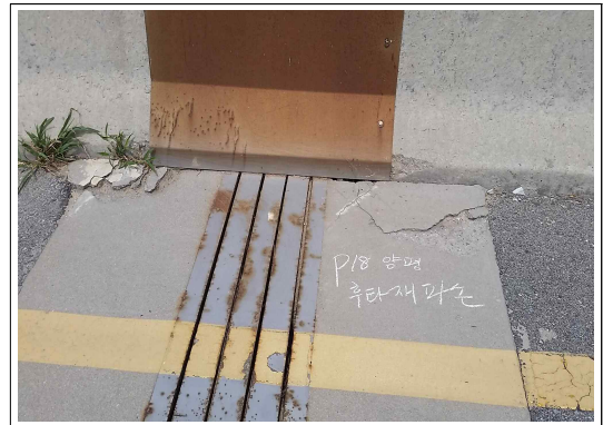
P18 (양평방향) 후타재 파손
