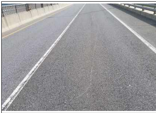
S23 (양평방향) 아스콘 소성변형
