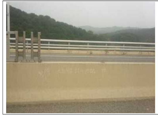
S8 중앙분리대 난간 탈락
