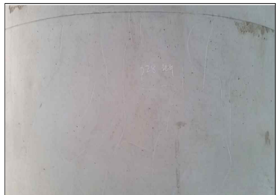
P28 (양평방향) 기둥부 망상균열
