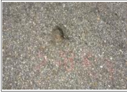
S28 (원주방향) 아스콘 파손
