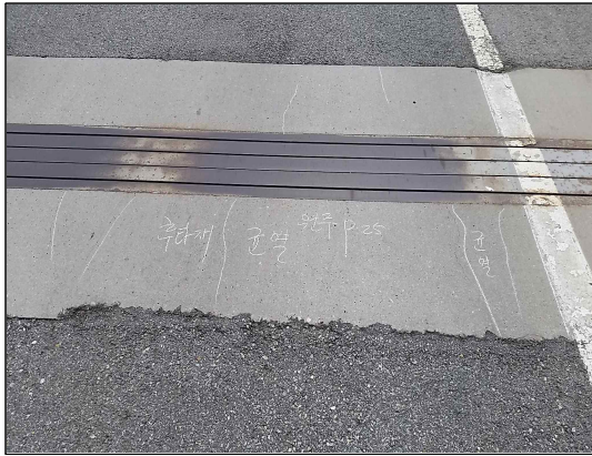
P25 (원주방향) 후타재 균열
