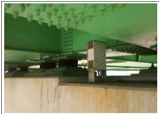
P1(원주방향) 코핑부 균열
