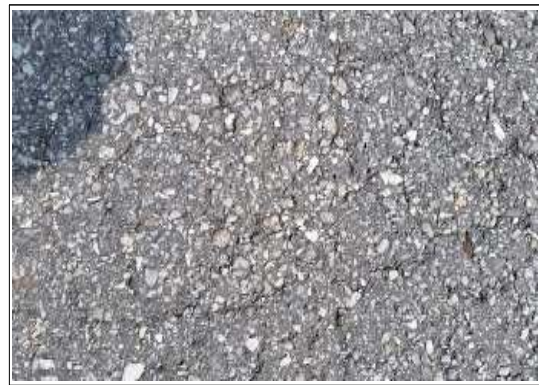
S18 (원주방향) 아스콘 망상균열
