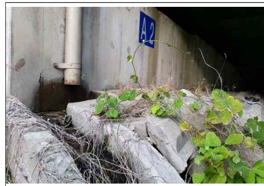
A2 (원주방향) 우수유입호안블럭하부범면세굴
