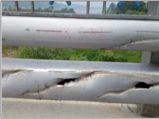
S32 (원주방향) 난간 파손(L=21.0m)
