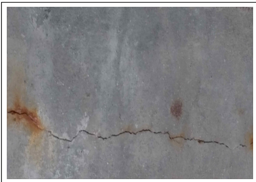
S5 (원주방향) 외측 캔틸레버균열 및 철근부식
