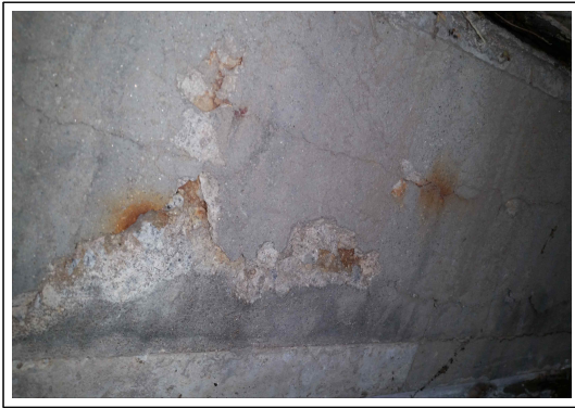
S1 (영평방향) 중분대측 캔틸레버균열 및 철근부식
