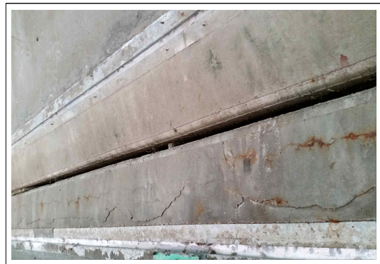
S4(양평방향) 중분대측 캔틸레버균열 및 철근부식
