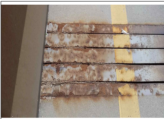
P25 (원주방향) 레일조인트부식유간부토사퇴적
