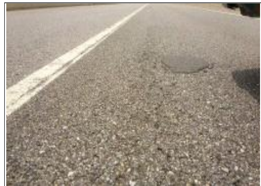
S28 (원주방향) 아스콘 포장 망상균열
