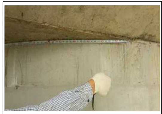
P8 (원주방향) 기둥부 균열크기측정
